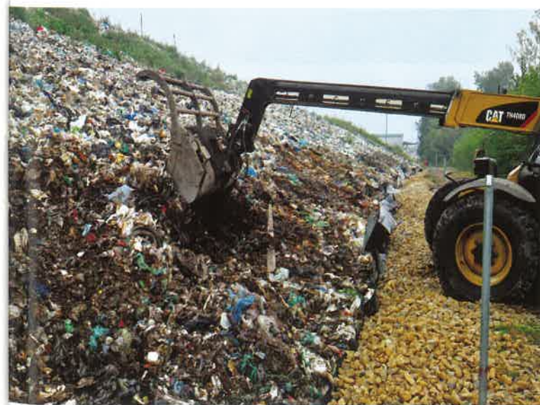
Slika 2: Komunalna deponija pred sanacijo zaradi okoljskih zahtev (foto P. Oprčkal)
